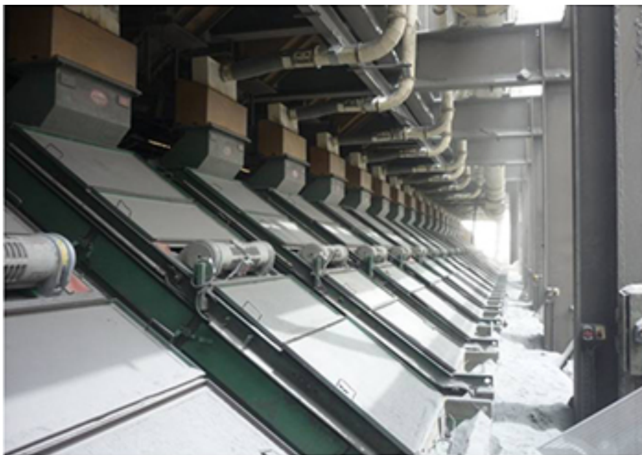
Dispositif de dépoussiérage Usine des Guelbs
