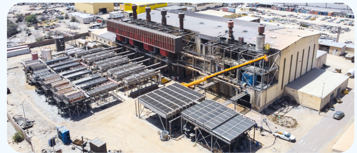
Centrale thermique de Zouerate
